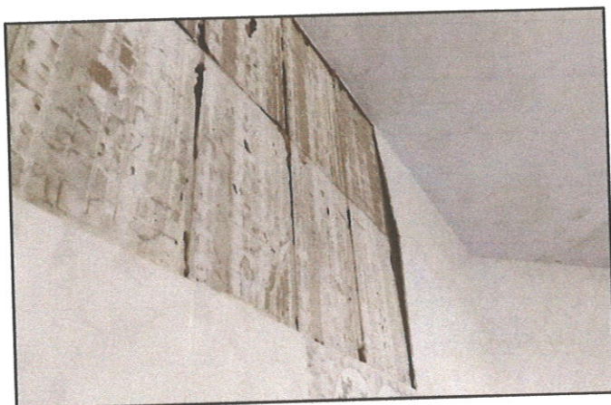
FIGURA 05 - Revestimento de parede quebrado
