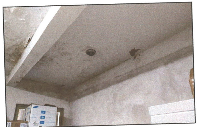
FIGURA 06 - Manchas de infiltração no teto
