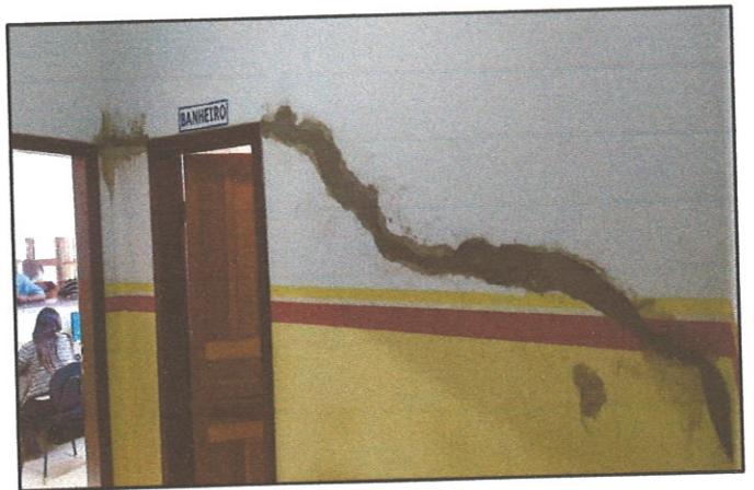
FIGURA 04 - Pintura de parede danificada
